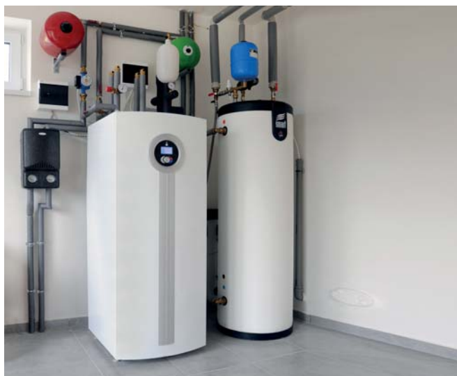
Švédské tepelné čerpadlo země/voda odebírající teplo z plošného kolektoru.
