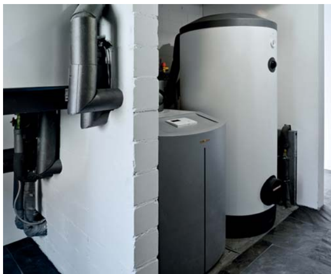
Německé tepelné čerpadlo země/voda odebírající teplo z vrtů.
